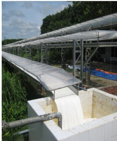
Máng Spillway - tách \text{NH}_3 bốc hơi tự nhiên
